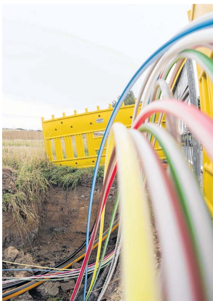
Für den Ausbau mit Glasfaserkabeln in Friedland und Umgebung soll im Herbst der erste Spatenstich erfolgen. FOTO: J. STRATENSCHULTE
