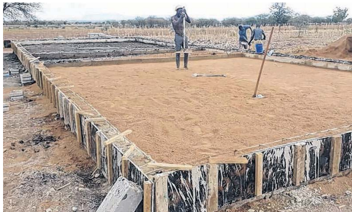
Die Vorbereitungen für das Fundament für die Kindergartenschule in Lutubiga in Tansania.
